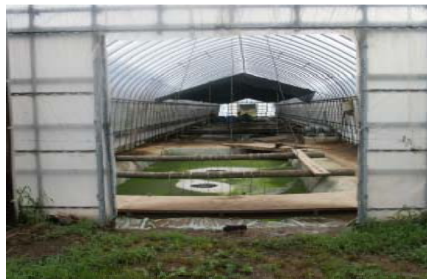
手前に見えるのが、第4槽で処理水の最終段階のもの。奥から手前に第1槽、第2槽、第3槽、第4槽となっている。
