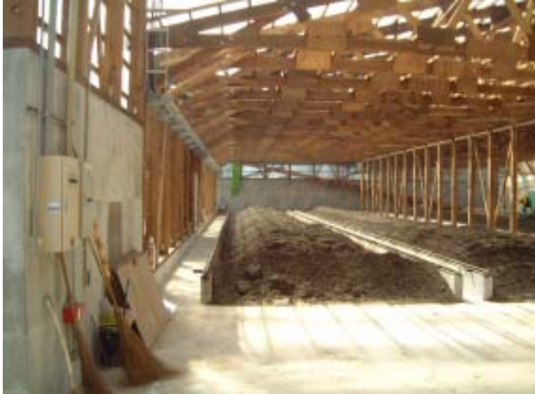
アンモニアによる腐食対策のため木造設計となっている。トラス構造により、低コストで支柱間10m程度と、高い作業性を確保している。
